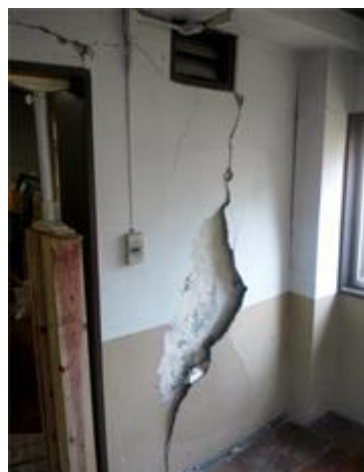
写真 3 震災で損傷した壁
