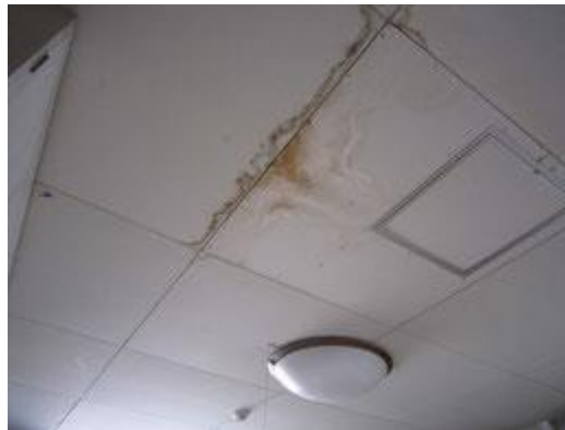
写真 11. 老朽箇所（天井）
